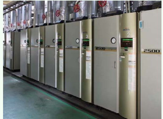
高効率型ボイラー
